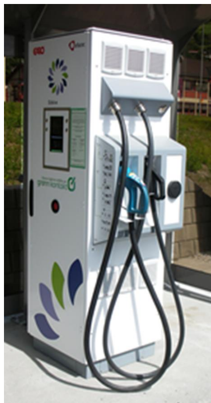
Ladepumpen ved Ringebu skystasjon
