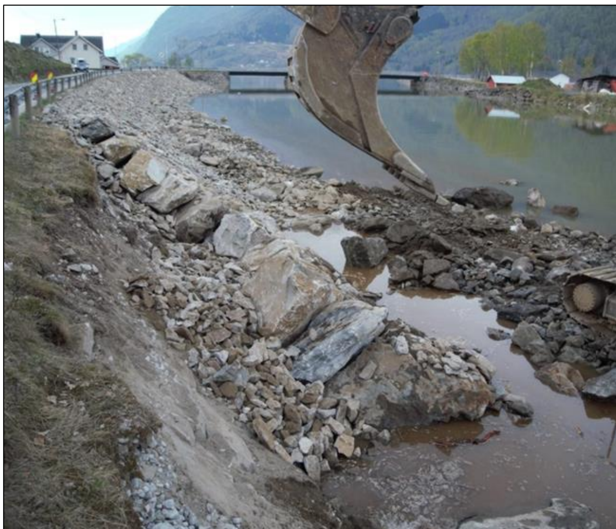
Figur 13: Erosjonssikring med plastringsstein under utføring med filterlag av grov pukk, d = 30\text{--}300\text{mm} rundt 0,5\text{ m} i tykkelse. Foto Jomar Bergheim, NVE (NVE, 2023)
