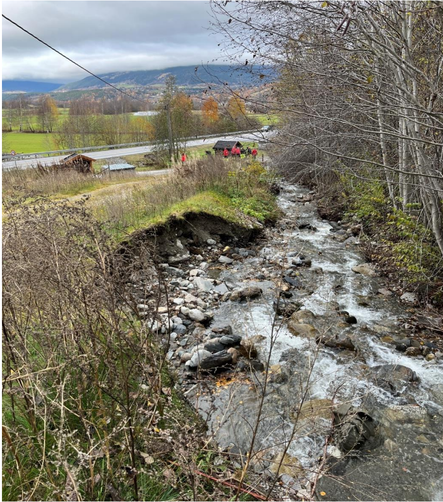
Figur 5: Bildet viser erosjonsskade nedstrøms bygninger (foto: NVE 16.10.24).
