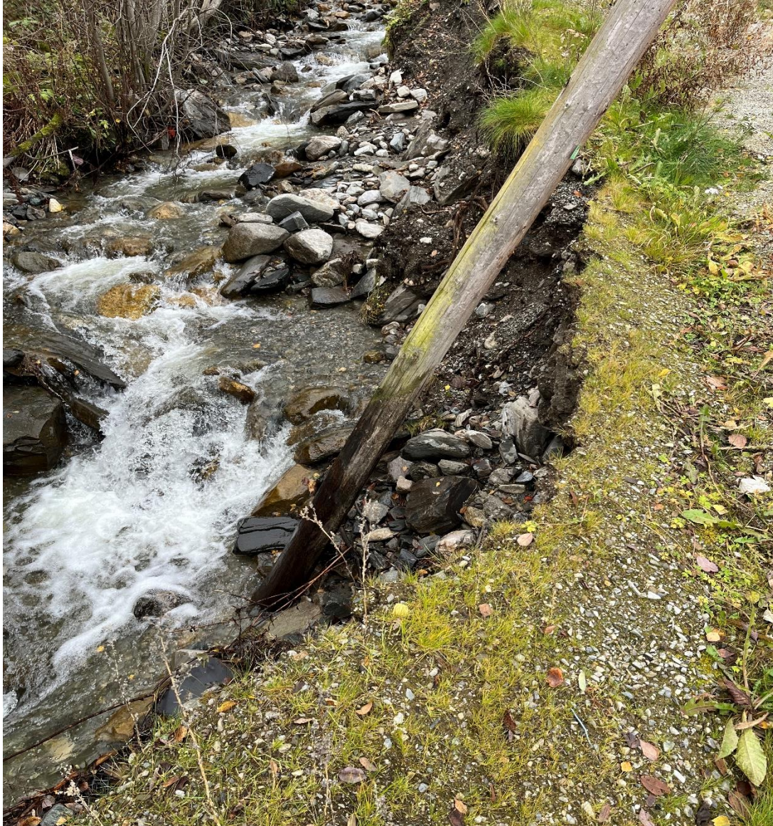
Figur 6 Bildet viser erosjon rundt stolpe til luftstreck. (foto: NVE 16.10.24):
